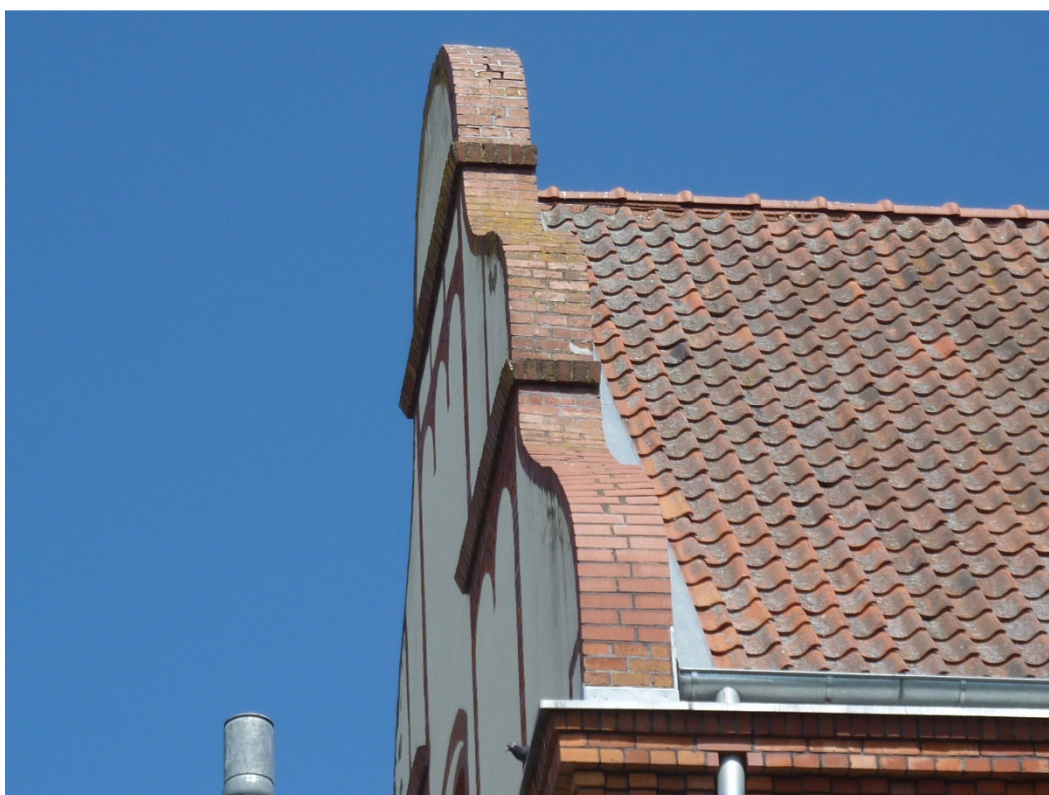
Zwieńczenie ceglane attyki ściany szczytowej (elewacja wschodnia)
