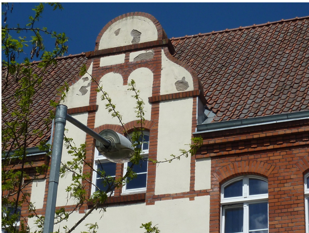
Zniszczone tynki attyki (elewacja południowa)
